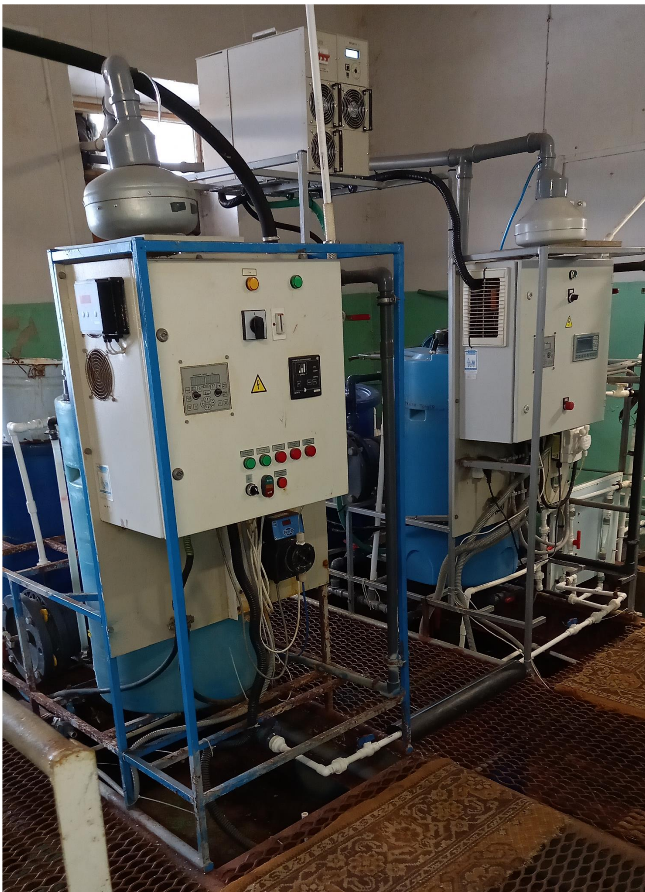
Рисунок 1.1.2 - Электролизные установки приготовления раствора гипохлорита
